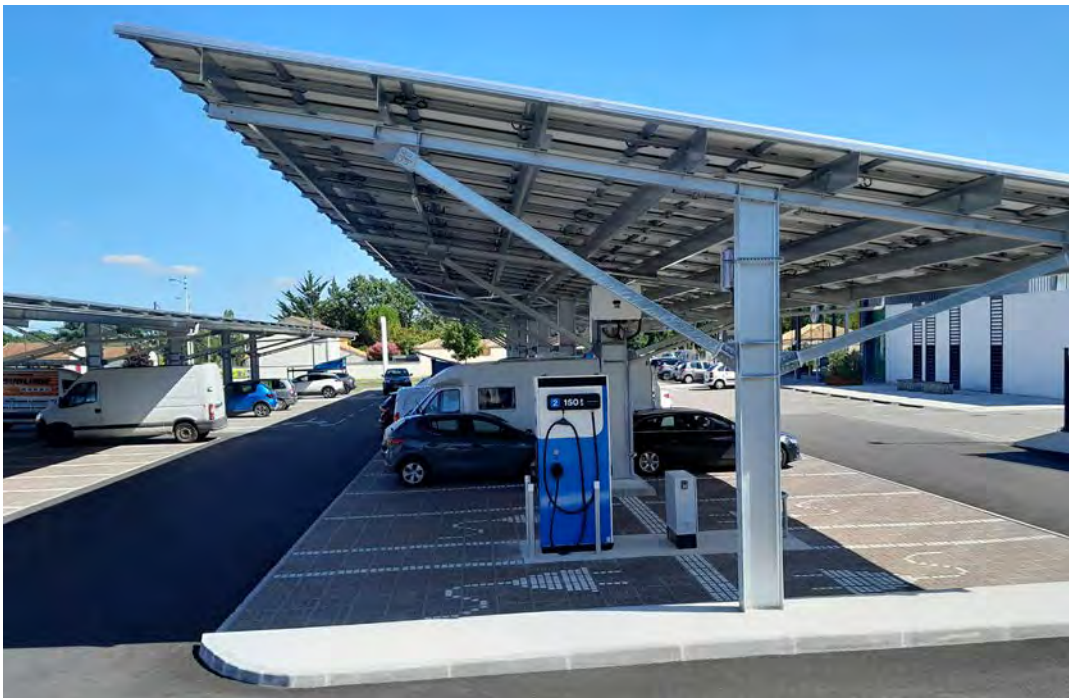
Les ombrières photovoltaïques du Super U de Saint-Yrieix-sur-Charente.
